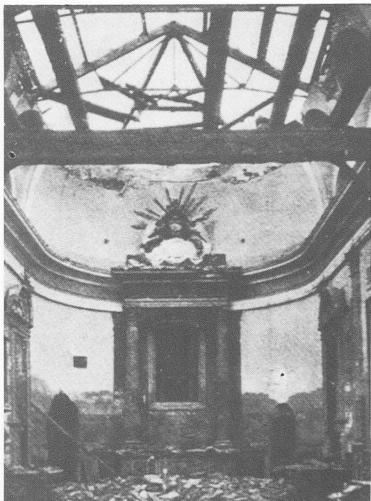
Después de pasada la inundación se hundió la bóveda de la parroquia de Marchalenes
