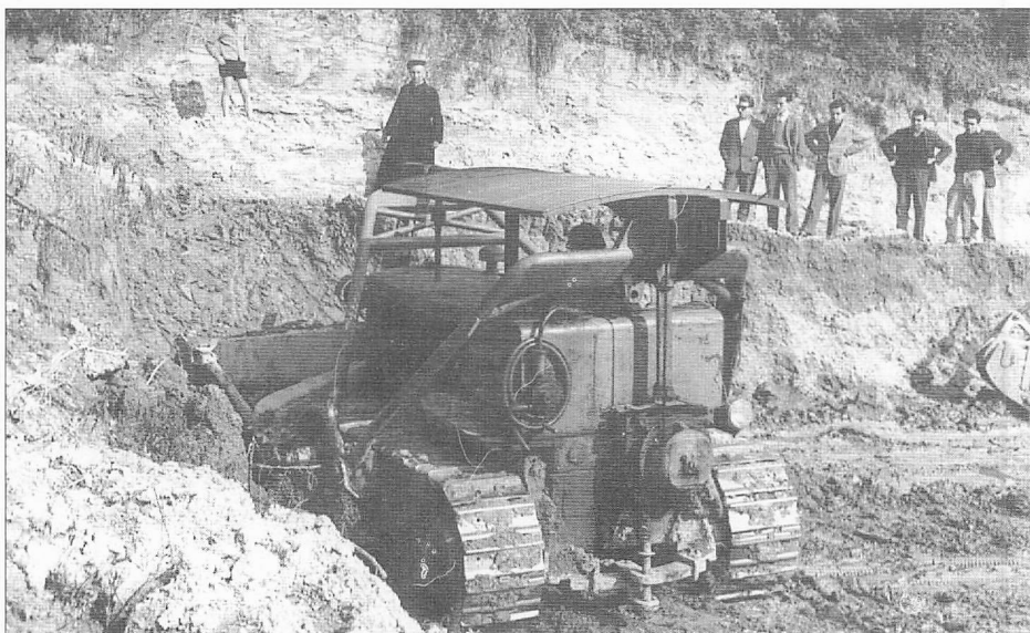
Don Celi, con alcuni giovani oratoriani, durante lo sbancamento della collina, per la costruzione dell'impianto sportivo di calcio (maggio 1959)
