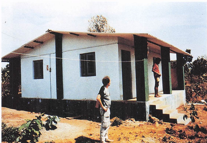
Una delle centinaia di casette plurifamigliari in costruzione nel grande centro di Vehololi, la città dell'amore.
