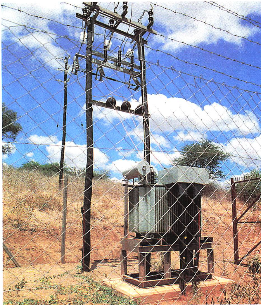
Dalle dighe del Tana arriva l'elettricità: la cabina di trasformazione.
