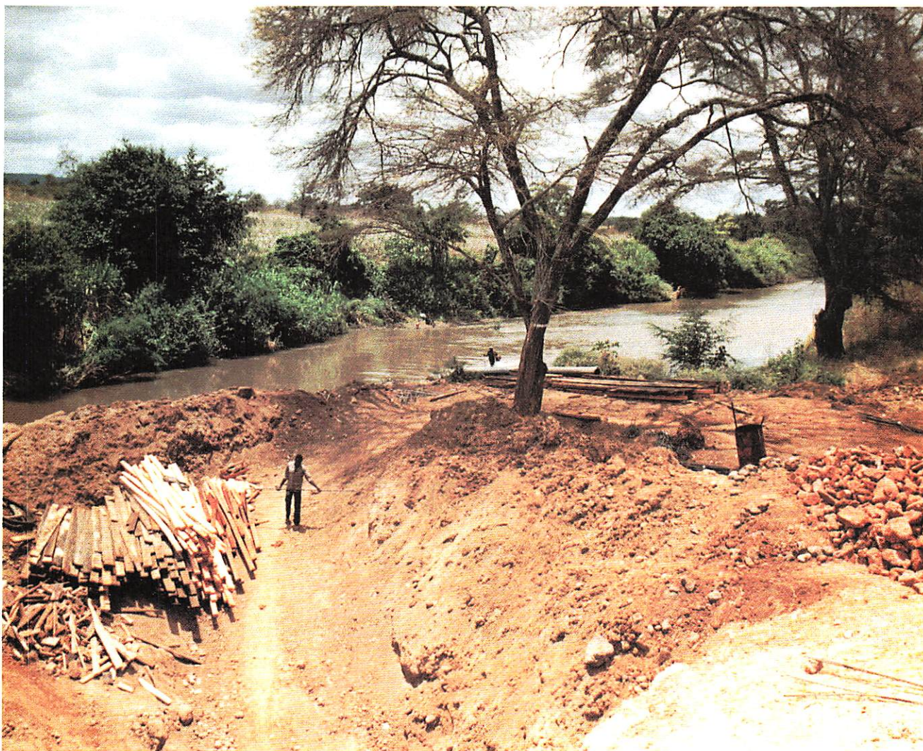
Dopo la piena si rifà il canale che collega il fiume con la centralina di pompaggio.
